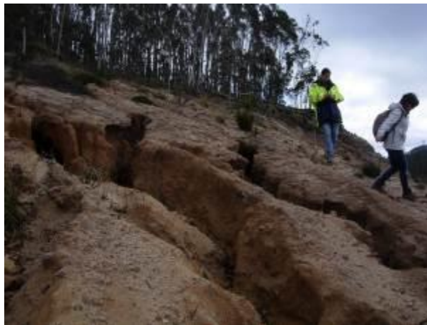
Fig.4. Sulcos escavados pela água nos terrenos sobranceiros do talude
